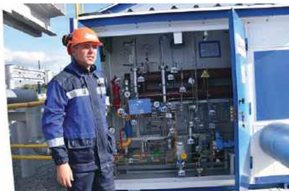
Знакомство с газораспределительной станцией
